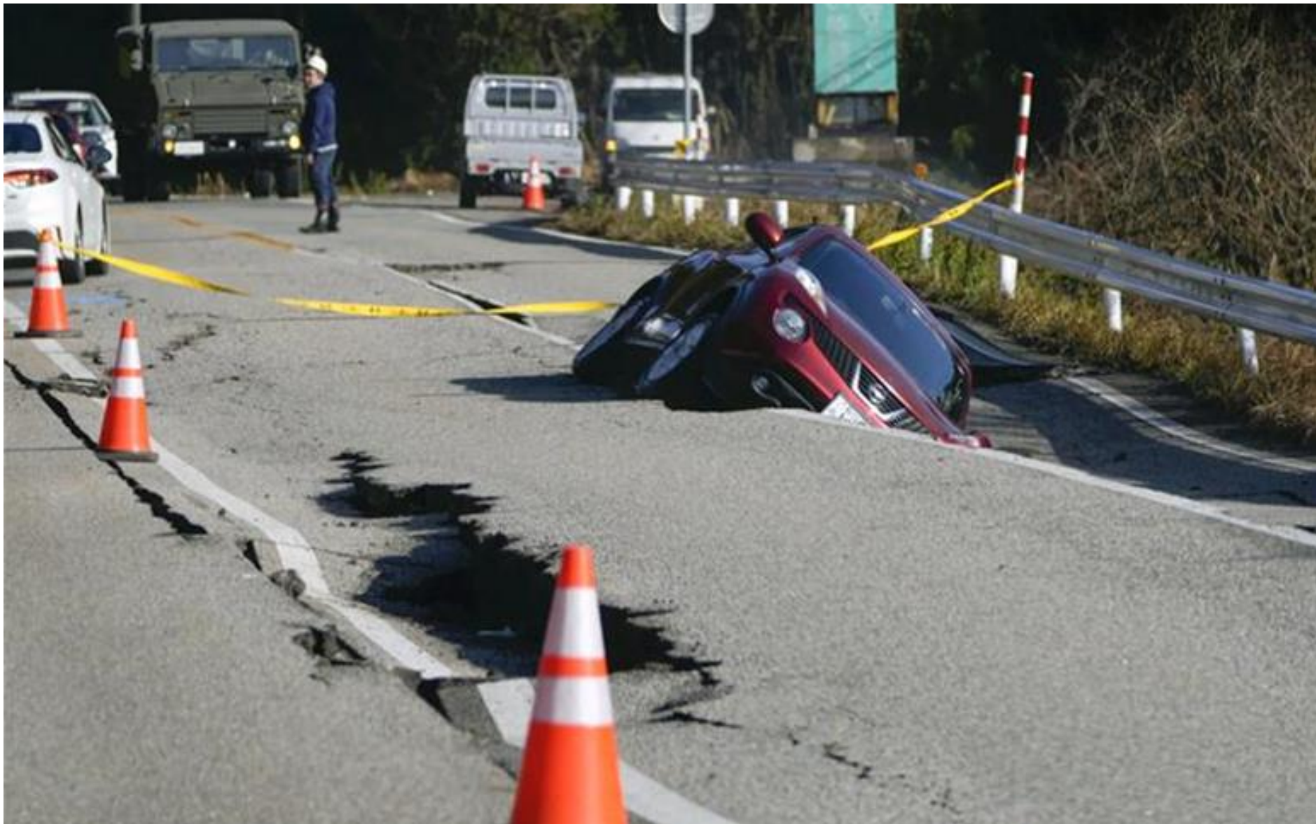
穴水町 道路の陥没に車両が落ち込んでしまった事態 (甲262)
