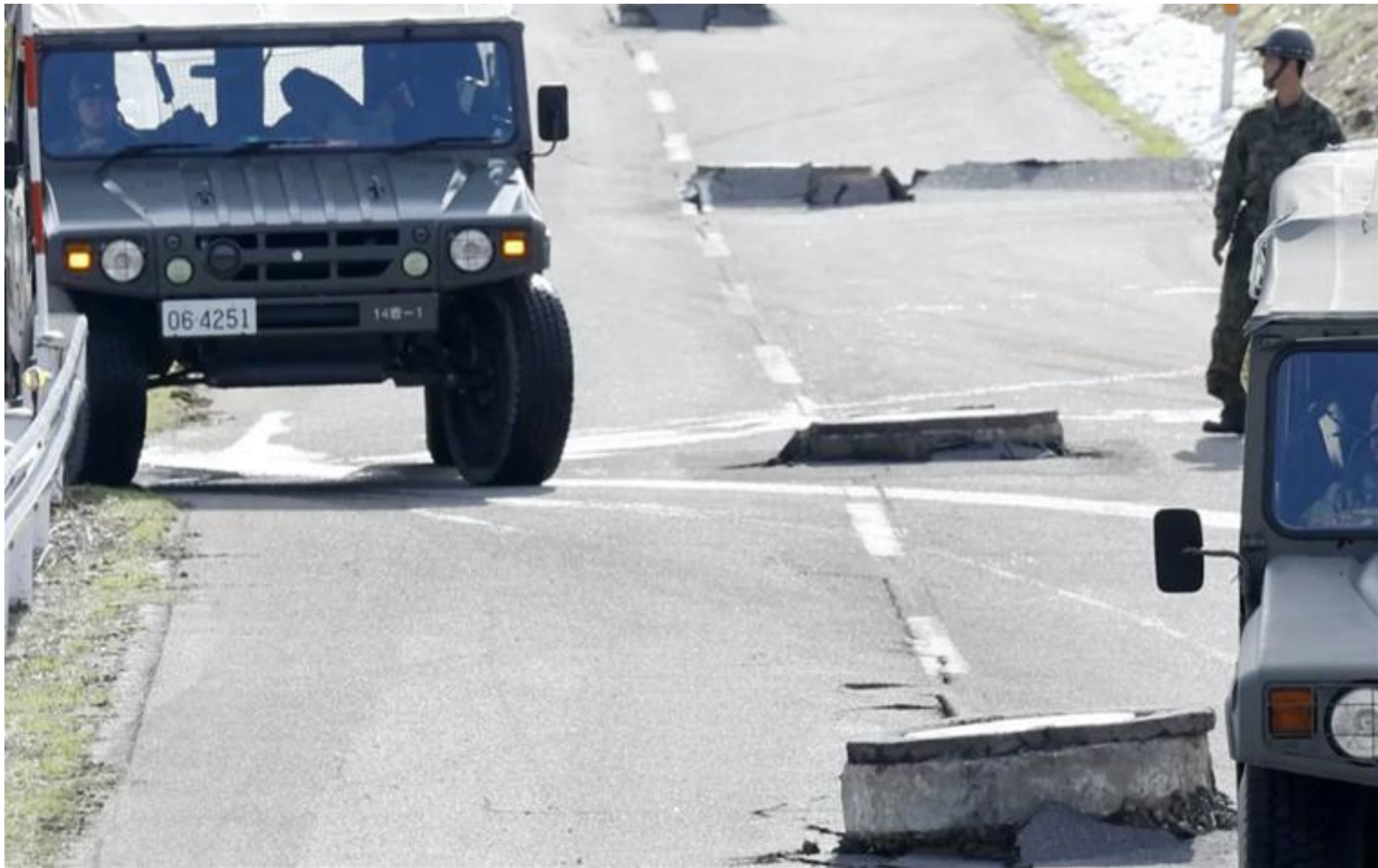
珠洲市 地震によって突き出たマンホール (甲262)
