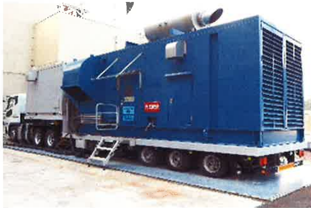
【図表 1 6 空冷式非常用発電装置】
