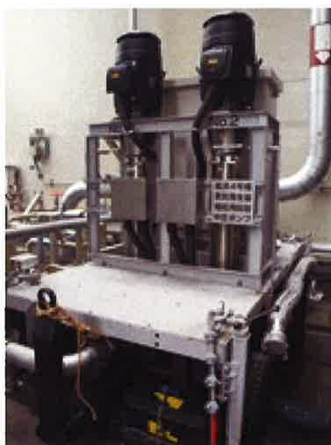
【図表 2 2 蒸気発生器補給用仮設中圧ポンプ】
