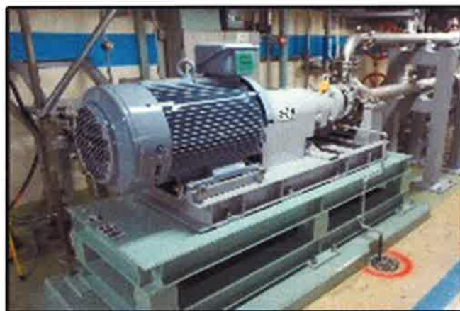
【図表20 恒設代替低圧注水ポンプ】
